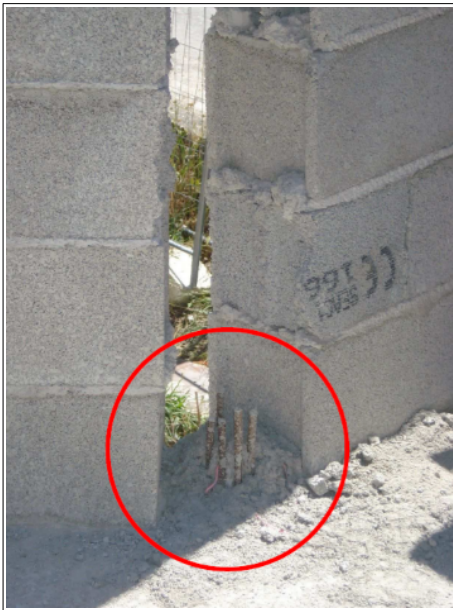
chaînage vertical : attentes trop courtes
