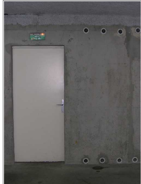
absence de signalisation d'une issue de secours, absence des plans et consignes d'évacuation dans un parc de stationnement
